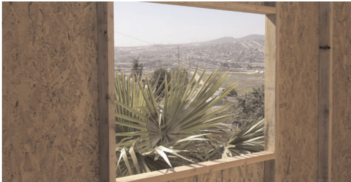
Cette maison en construction à Tijuana baigne dans la lumière du soleil.
