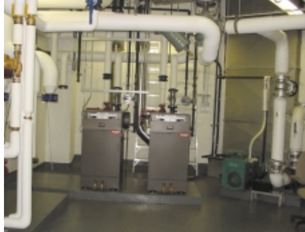
Nouveau système de chaudière à l'immeuble Hendry House
