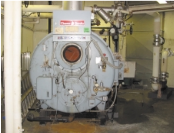
Vieux système de chaudière à l'immeuble Hendry House
