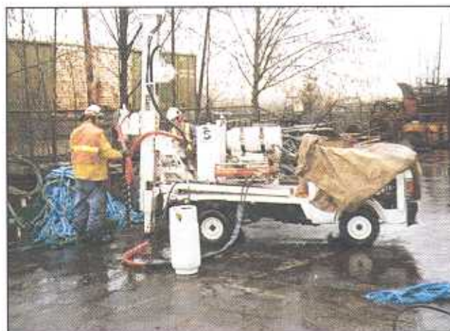
Travaux de forage au site d'Anvil Way qui fourniront d'autres données sur la caractérisation des déchets.
