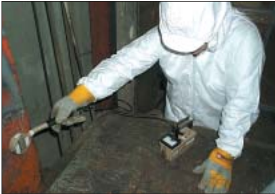
Les autres sites de déchets accumulés qui ont exigé l'intervention du Bureau en 2000-2001 comprennent cet immeuble de la région de Toronto. Les travaux ont été exécutés dans les délais impartis par la CCSN.
