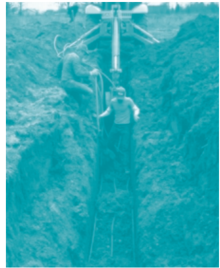
À l'aide d'une pelle rétrocaveuse, on creuse une tranchée destinée à l'installation d'une boucle souterraine.
