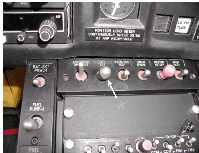
Photo 3. Commutateur HYD TEST du circuit hydraulique
