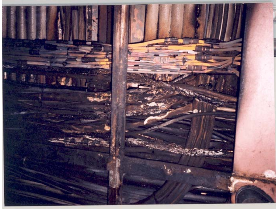
Photo 2. Vue du câblage brûlé au-dessus du pont de la salle de commande des machines (noter l'effet de la chaleur sur les tubes en cuivre)
