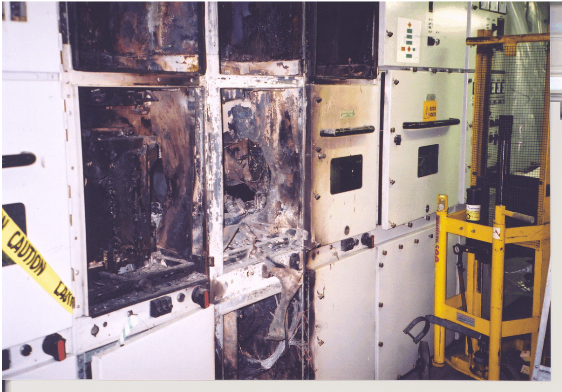
Photo 1. Vue du disjoncteur et des consoles des relais du GED 2. Les consoles du GED 1 et du disjoncteur de couplage se trouvent de part et d'autre.
