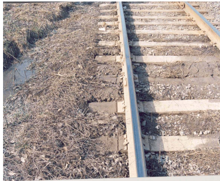
Figure 1. Ballast contaminé et pompage de la voie
