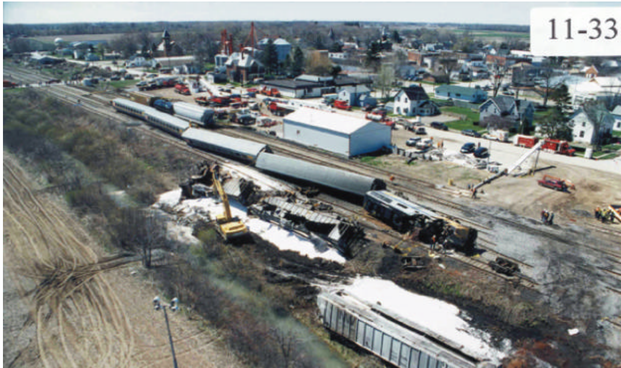
Figure 1 - Photographie aérienne du lieu de l'accident à partir du sud-est
