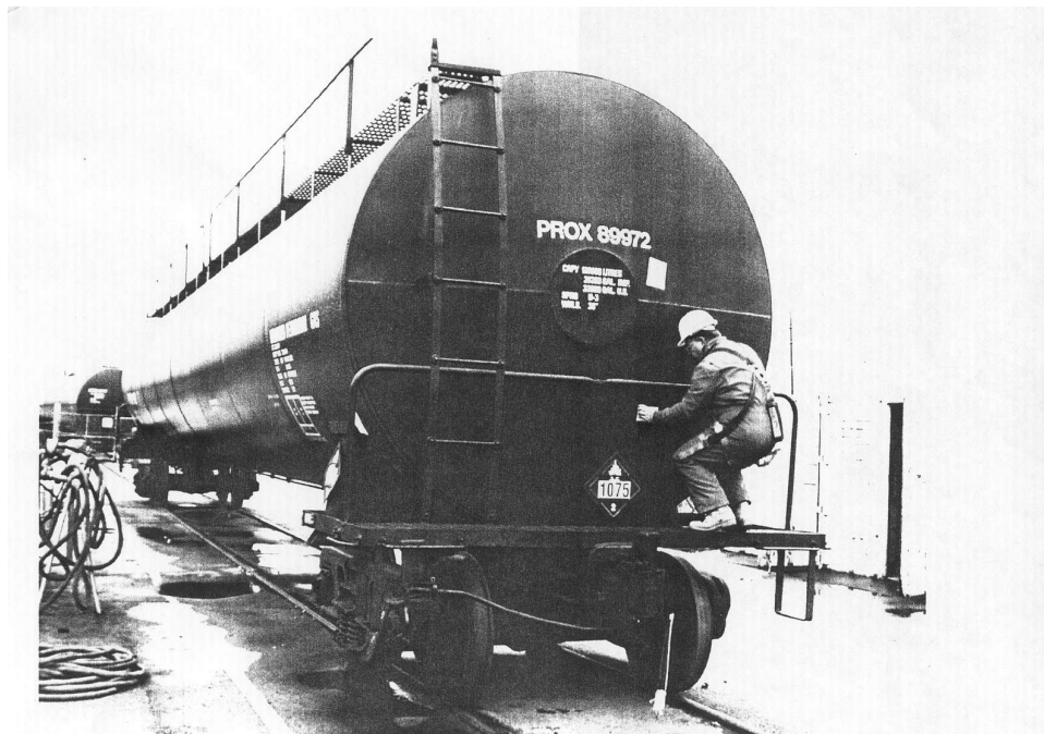
Examen de l'isolant à un des points d'inspection où l'on a découpé l'enveloppe de la citerne
