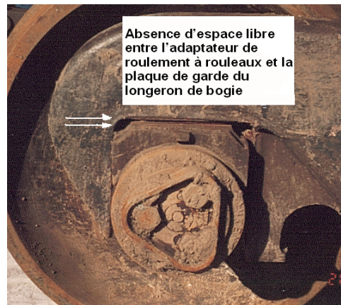
Photo 3. Absence d'espace libre au-dessus de l'adaptateur du wagon n° CGTX 64098. Noter aussi les marques sur le voile de la roue, dues au contact avec des matériaux non ferreux (p. ex. ballast et traverses).
