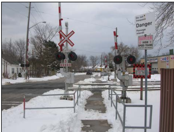
Photo 4. Barrières pour piétons au passage à niveau du chemin Alexandra dans la subdivision Oakville à Mississauga (Ontario)
