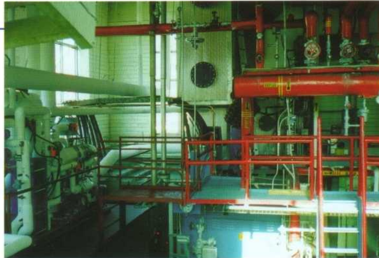
Chauffe-eau à contact direct à température double installé à l'Hôpital Général de Sorel
