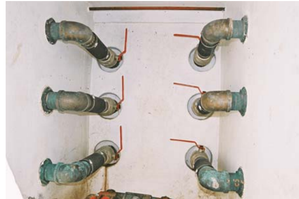
Photo 3. Vue intérieure dans la cambuse montrant les conduites de refoulement reliant les viviers au tableau arrière. Chaque conduite a une soupape de 76 mm.
