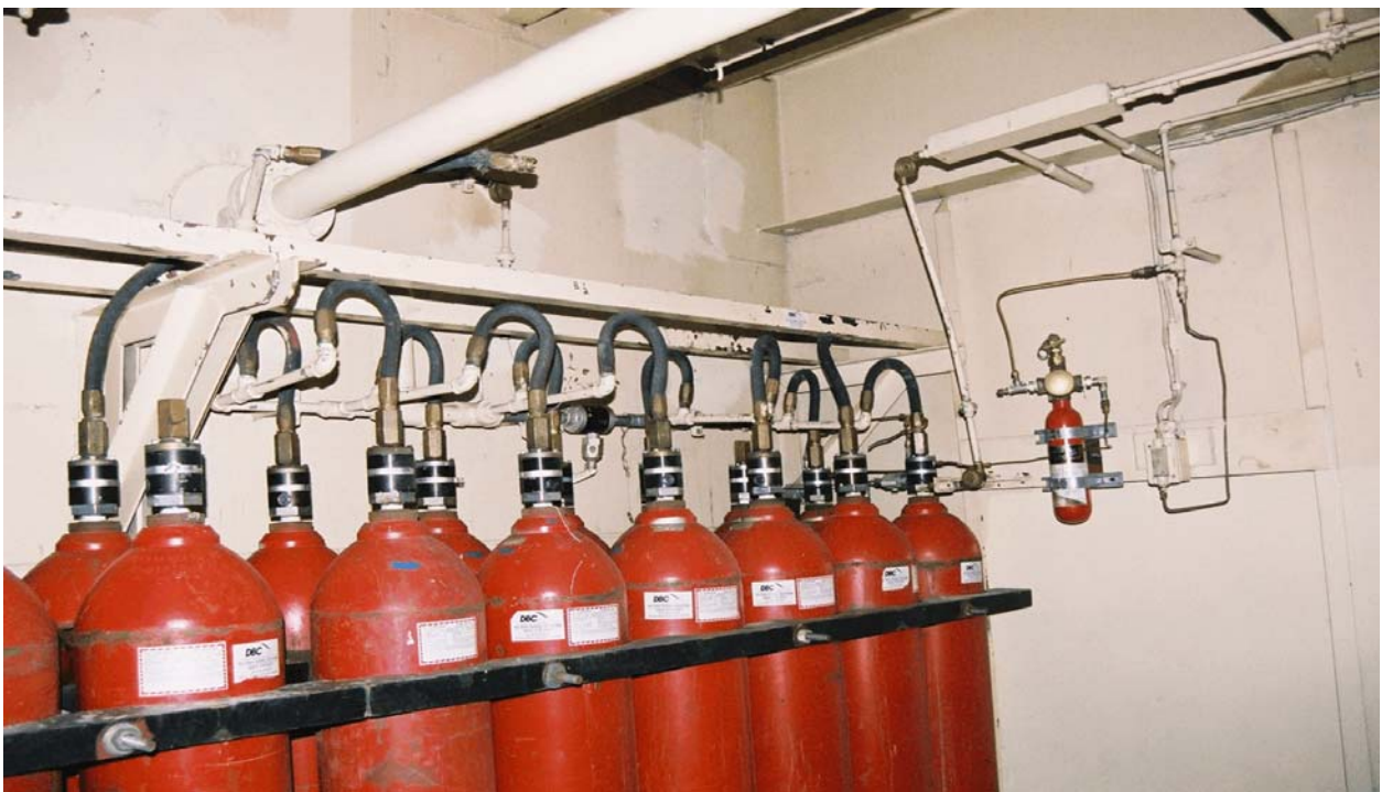
Photo 2. Batterie de bouteilles de CO 2 et tubulure de distribution
