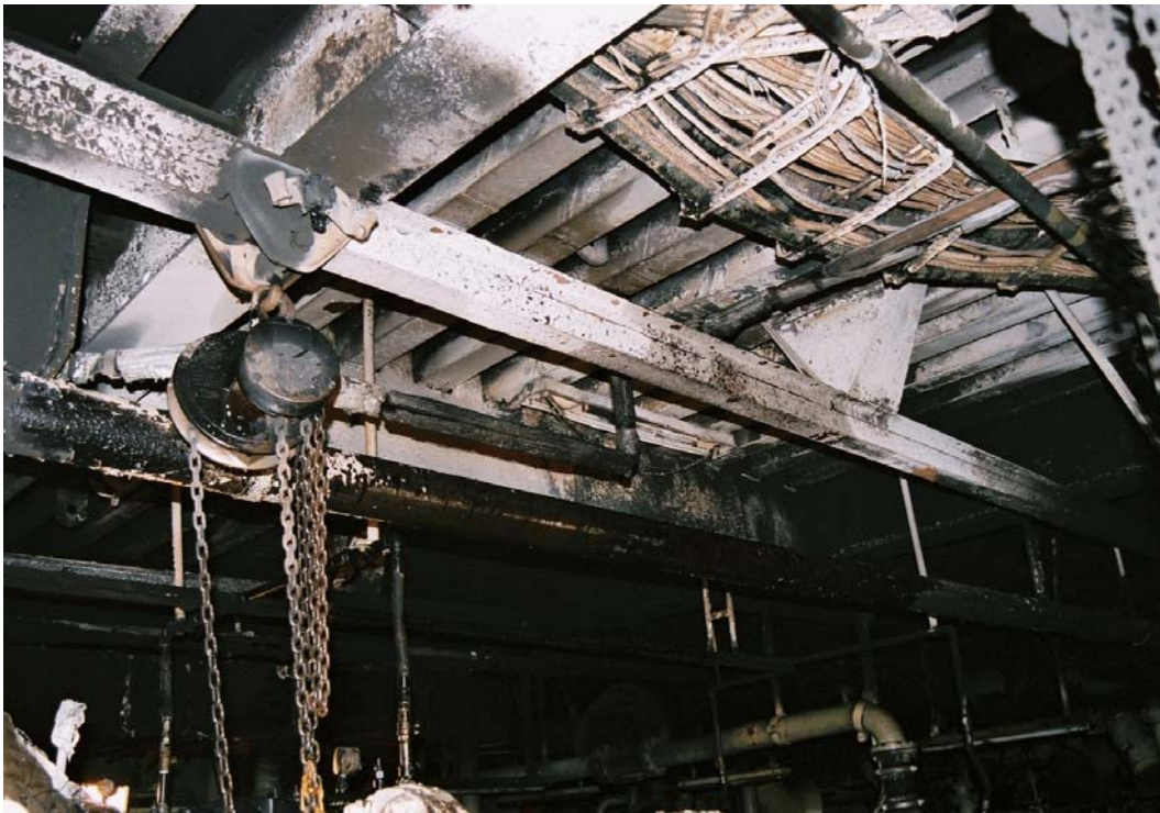
Photo 3. Dommages à la salle des machines et aux câbles électriques
