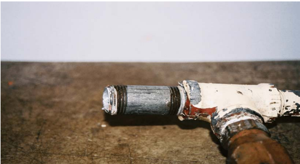
Photo 4. Section de tubulure fracturée
