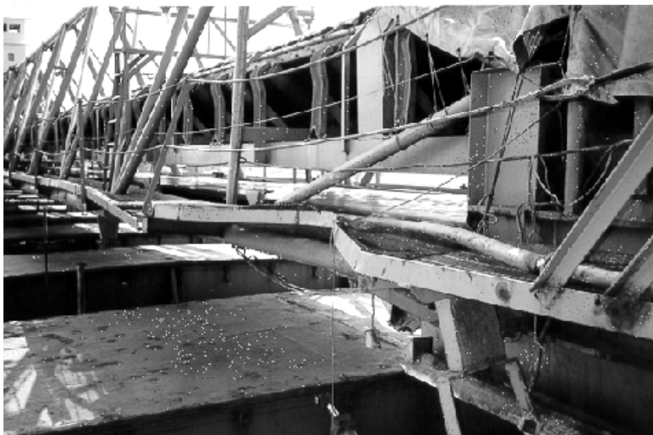
Passerelle du mât de déchargement endommagée au point de contact avec les lampadaires
