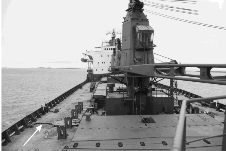
Photo 4. Emplacement de la fracture sur le pont principal (voir la flèche)
