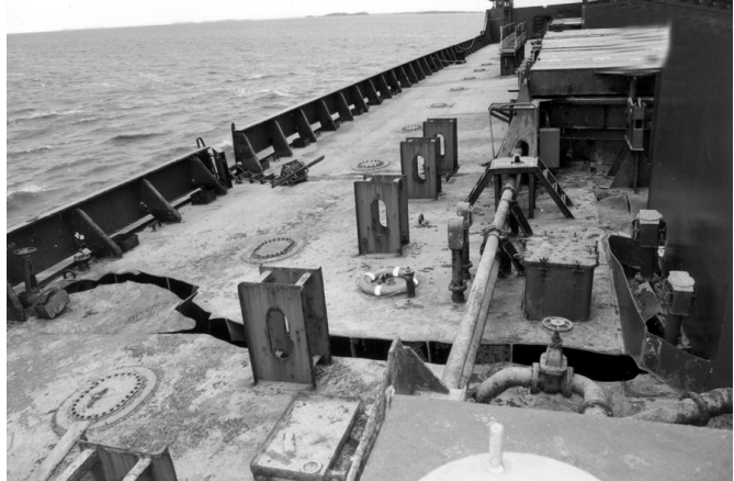
Photo 5. Fracture sur le pont principal
