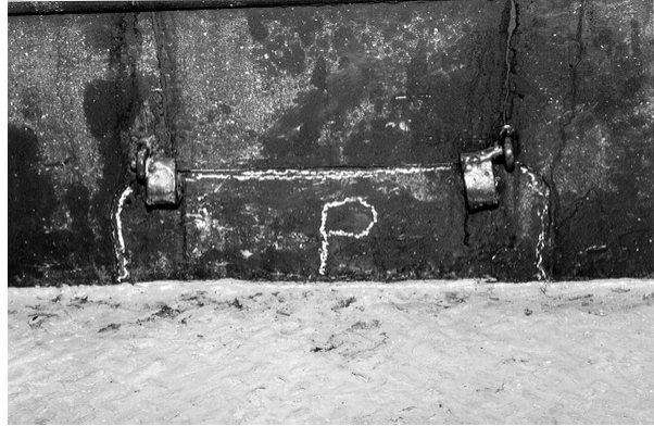
Photo 7. Sabord de décharge du pont principal obturé par soudage. Celui de tribord est similaire.
