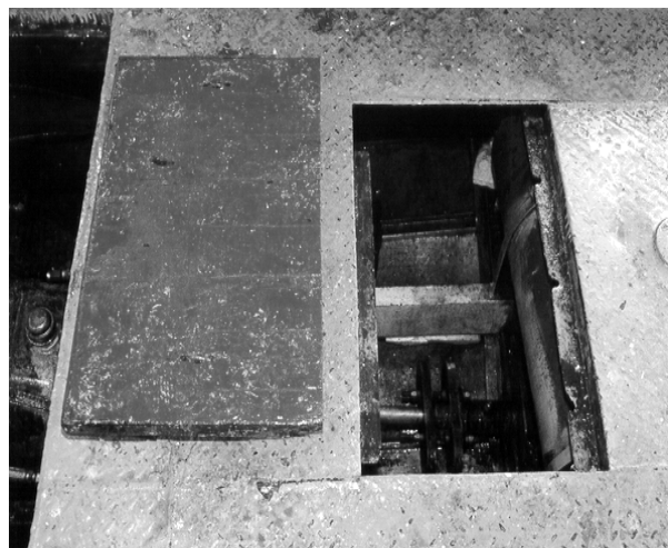
Photo 3. Écouille du pont principal qui n'a ni joint d'étanchéité ni dispositif de fixation du panneau de bois affleurant
