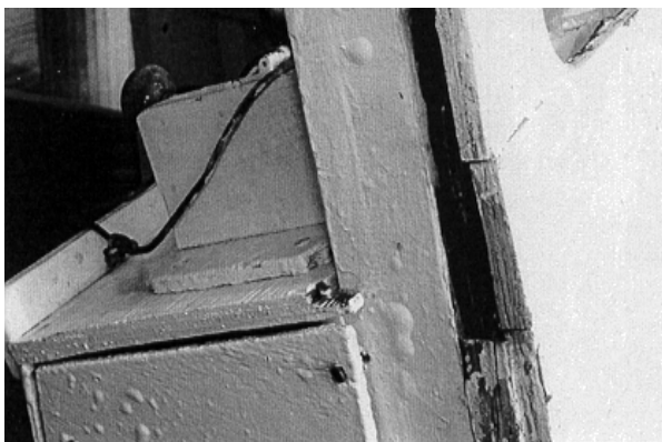
Photo 8. Désintégration due à la pourriture sèche de l'avant de la superstructure faite de contreplaqué, au droit du cadre de la porte avant.
