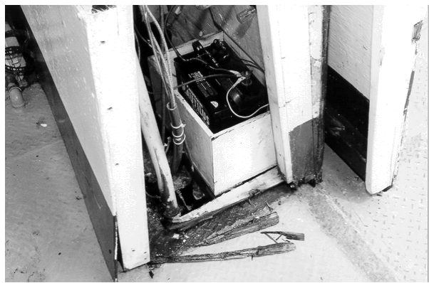
Photo 9. Désintégration due à la pourriture sèche du cadre de la porte et de la base du pupitre, et corrosion au droit de l'ouverture de forme irrégulière dans le pont principal.
