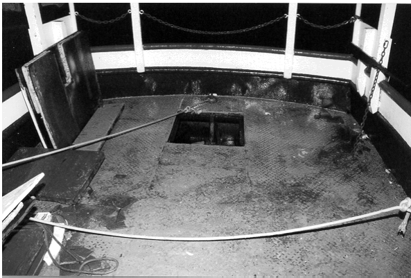
Photo 2. Vue de l'extrémité arrière du pont principal montrant le pavois d'acier intact et l'écouille dans le pont principal, qui n'a ni joint d'étanchéité ni dispositif de fixation du panneau de bois affleurant.
