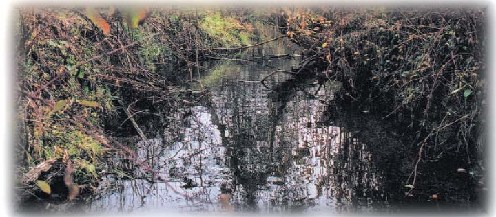
Les drains municipaux font légalement partie intégrante de l'infrastructure de la municipalité.
