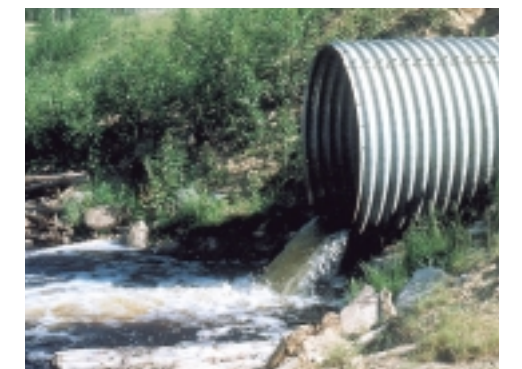
Des ouvrages de drainage mal installés font obstacle au passage des poissons.
