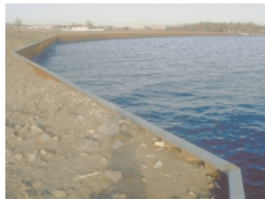
L'usage de murs de soutènement verticaux offre peu d'habitat pour le poisson.
