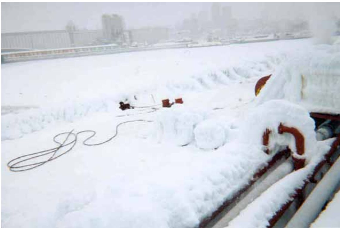
Figures 5.3F – Pont, tuyauterie et soupapes inaccessibles
